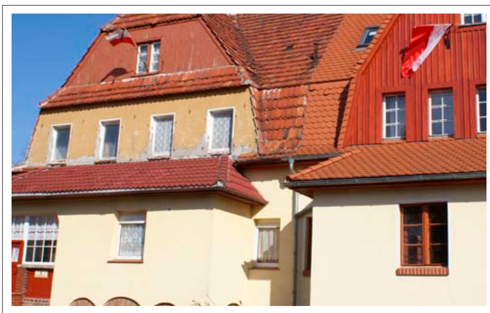
Wymiana stolarki okiennej bez zachowania podziałów lub kształtu otworów
